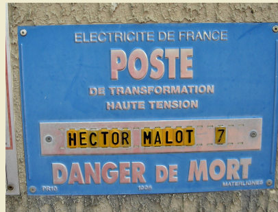
TRANSFORMATEUR HECTOR MALOT, dans le square éponyme à La Bouille (76).
